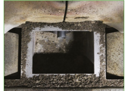
Espace en dessous du brûleur
